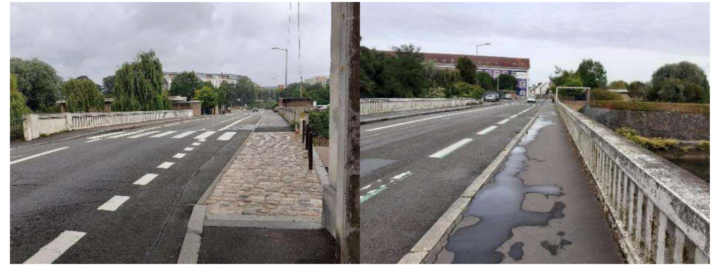
Figure 231 : Photographie du pont d'Eichthal (gauche) et du pont des Tabacs (droite) – SERUE Ingénierie
